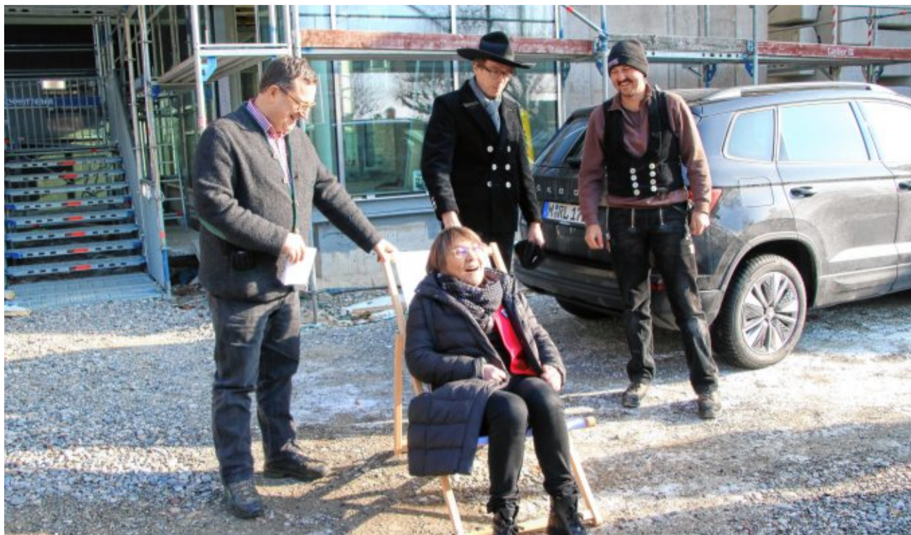
Von den Zimmermännern Quirin Säger und Florian Fluck gibt es zum Richtfest des Psychiatrischen Behandlungszentrums Waldshut eine Klappstühle für die Ärztliche Direktorin Claudia Vallentin und den Betriebsleiter der ZfP Reichenau, Jochen Reutter. BILD: MELANIE VÖLK
